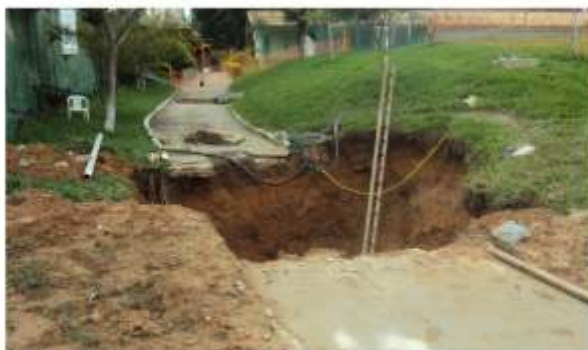
31/12/2011 Com as fortes chuvas de fim de ano, manilha se rompe e abre-se enorme cratera na Área do Tatu.
